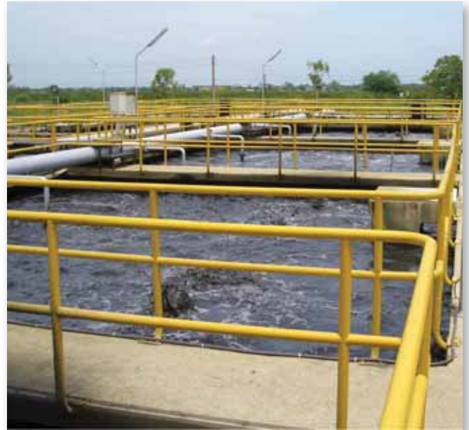
ภาพที่ 1 แสดงบ่อเติมอากาศ (Waste Water Treatment)
